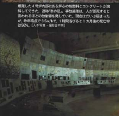
⑥石棺内部。光は照明ではなく、全て太陽光。石棺は事故直後、被曝の危険で長時間作業ができず、遠隔操作機械も用いて突貫工事で建設された。そこに老朽化が加わり、もはや密閉を保てない。屋根の隙間からは雨水も浸入。外壁も一部が壊れ、土壌の危険すらあるため、2012年完成を目標に新たな石棺建設計画が進んでいる。(入手写真・撮影日不明)
